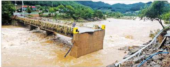
강원도 춘천군 내면 강변에 내린천을 가로지르는 가림교 일대가 3일 전날 밤새 내린 폭우로 유실돼 20여 가구 50여 명의 주민이 고립됐다. 춘천군 내면 지 김준식 기자
