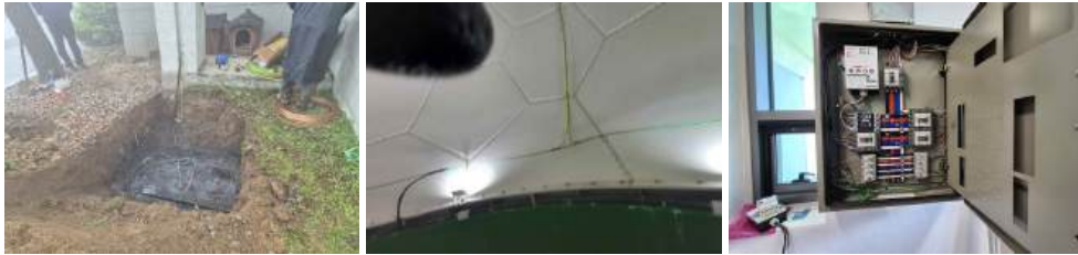
그림 3-142 광덕산기상레이더관측소 피뢰설비 보강
