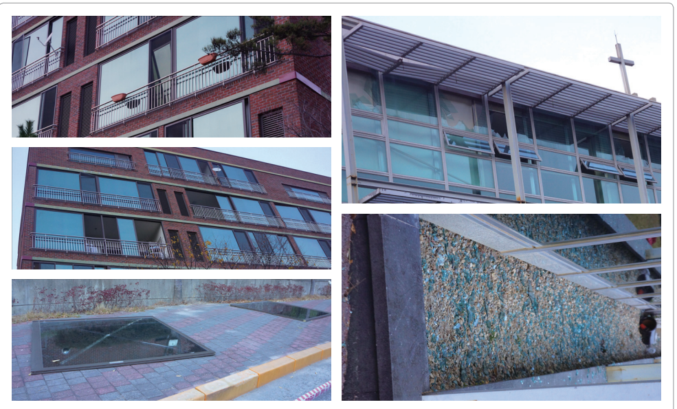
그림 3.7 포항지진 피해. 창문 탈락 및 파손(한동대학교)
