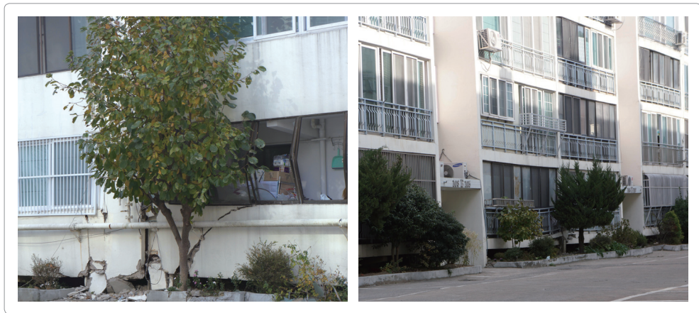
그림 3.3 포항지진 피해. 건물피해(흥해읍 대성아파트)
