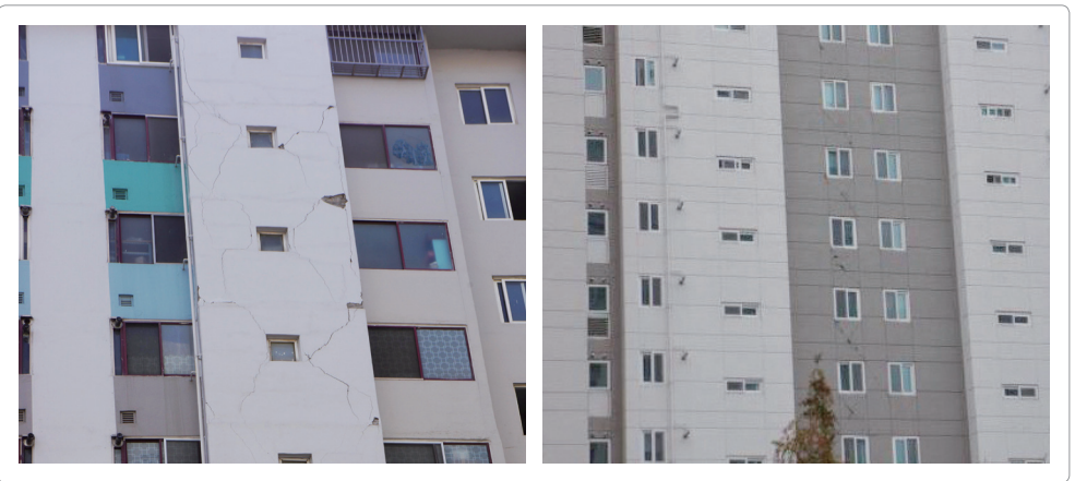
그림 3.6 포항지진 피해. 고층아파트 외벽 균열(흥해읍, 장성동)
