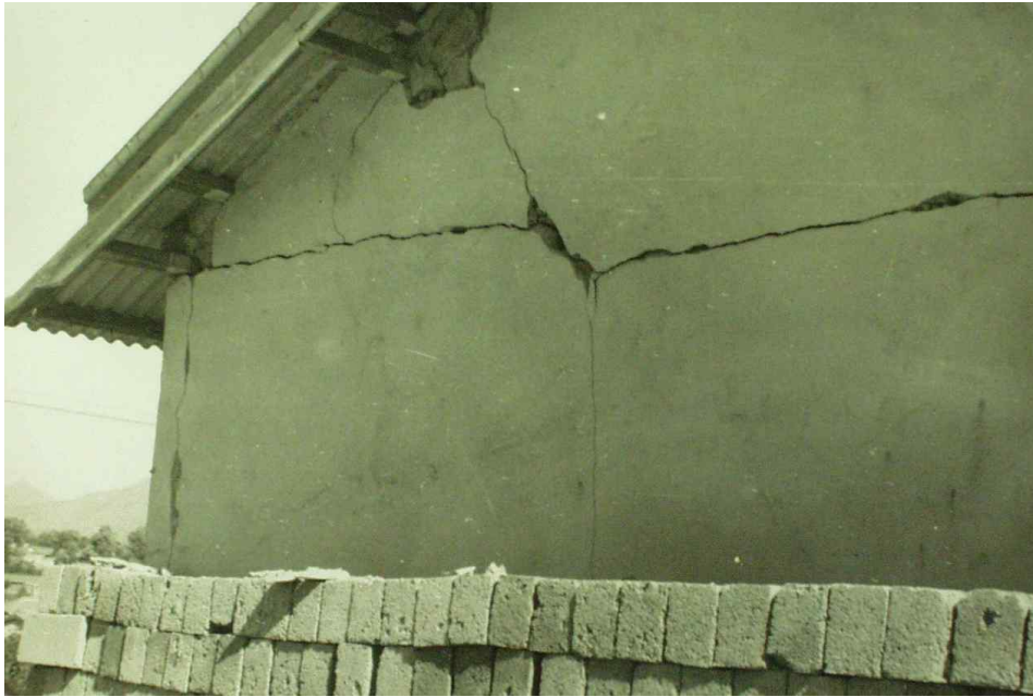
그림 2 홍성지진('78. 10. 7)시 가옥의 균열 장면
