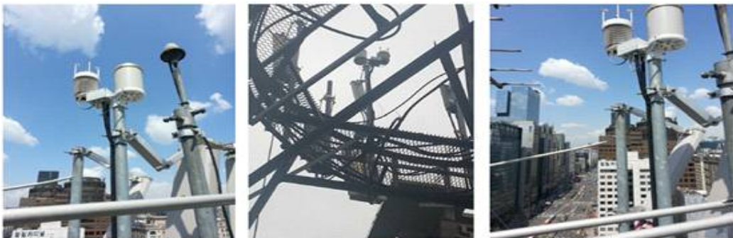
[그림 2-10] 통신기지국내 기상관측장비 설치 전경
